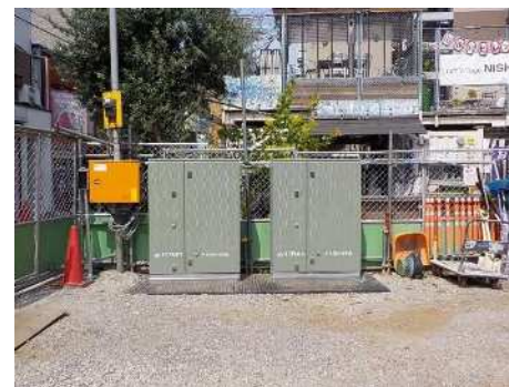
図5-7 防災生活道機能維持事業を活用し無電柱化した事例 (目黒区原町一丁目)
